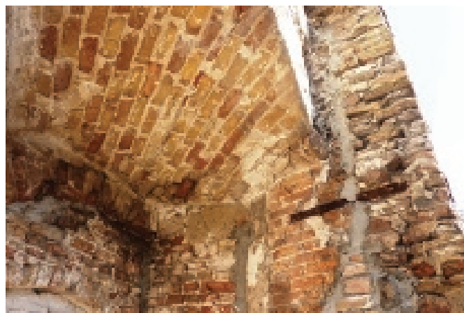
16 De zijmuur van een achterhuis van Oude Delft 153 is, wellicht slechts als tuinmuur resterend na afbraak van dat zijhuis, ooit losgescheurd waarna de scheuren zijn aangesmeerd en de muur met ijzeren krammen aan het erachter staande metselwerk werd verankerd. (FOTO'S WIM WEVE)
